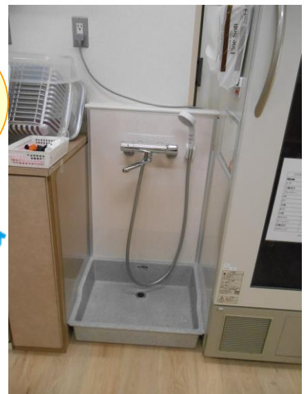
《処置室 足洗い場》
